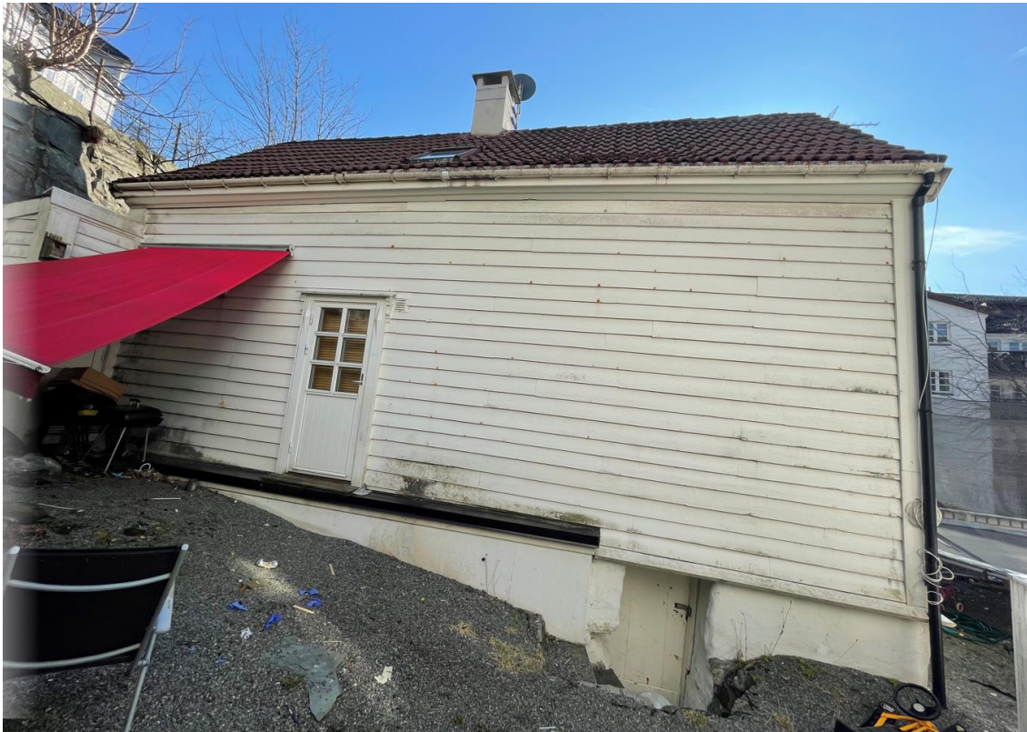
Figur 2-12 Fasade mot nord. Bildet viser den påstøpte kjellermuren. Foto: Asplan Viak.
