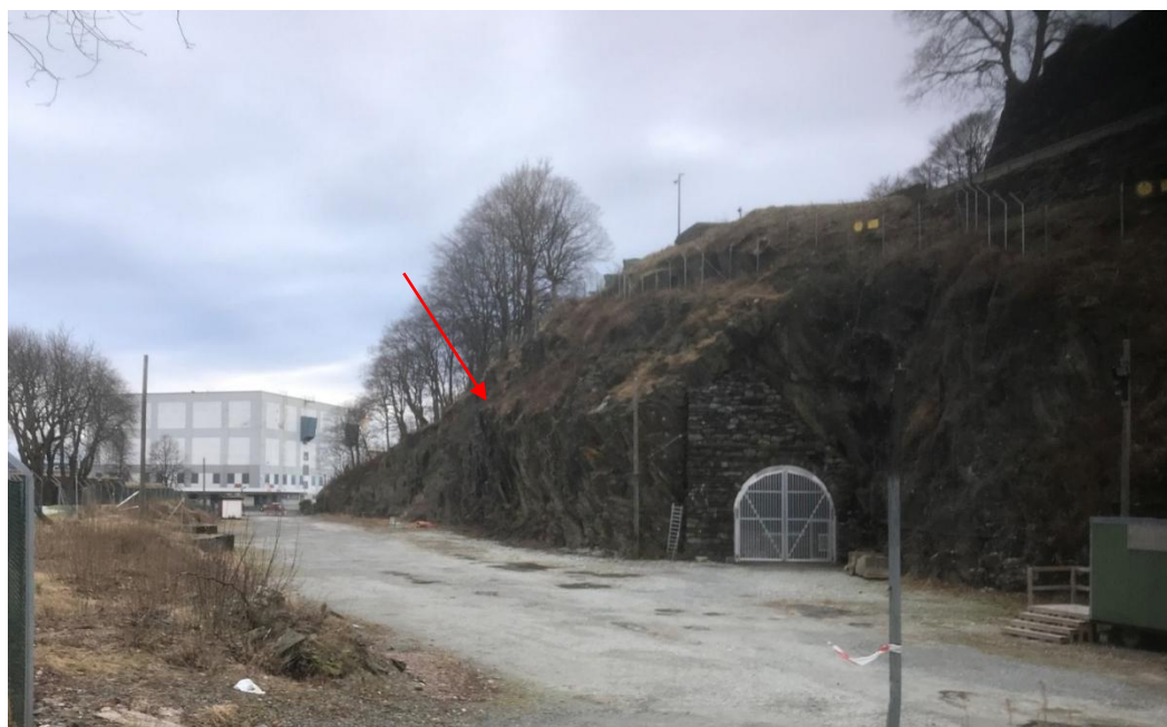
Figur 4-5: Riggområde Koengen, sett mot nord/innkjøring fra Bontelabo. Bergskjæring med potensiell fare for steinsprang (rød pil).
