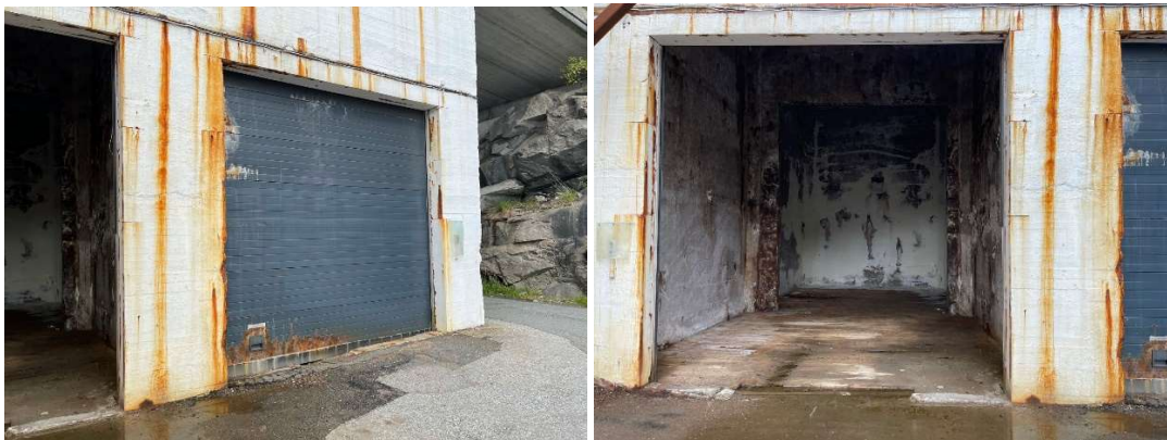
Figur 3-26: Fasade mot sør. Port til silorom og ett av silorommene som var åpen. Foto Norconsult 2021
