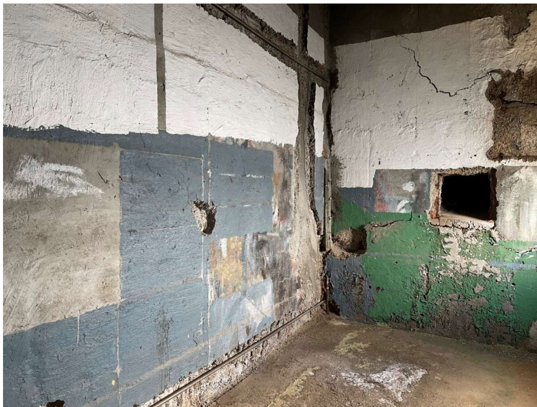
Figur 3-35: Detaljer fra tilstøtende rom. 2.etasje i den sørvestlige delen av bygget. Norconsult 2021.
