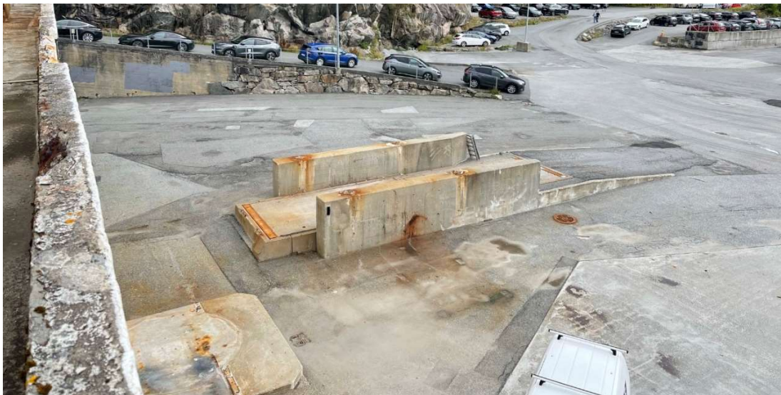
Figur 3-32: Betongfeste til glassfibersilo fra 2002, som nå er fjernet. Norconsult 2021.
