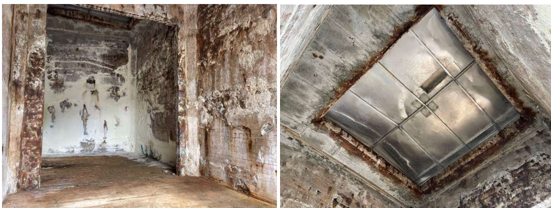
Figur 3-27: Åpent silorom innvendig. Bildet til høyre viser takluke for saltfylling fra tak. Foto Norconsult 2021.
