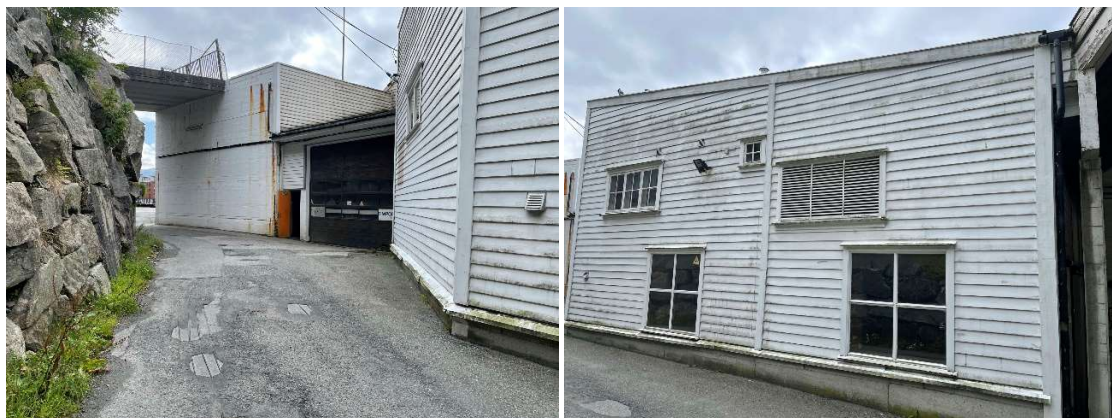
Figur 3-5: Fasade mot nord-øst, inn mot fjellskjæring under Strandens grend. Dagens adkomstveg til nabobebyggelse. Foto Norconsult 2021.
