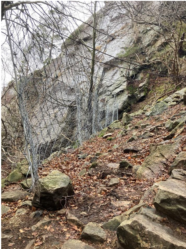
Foto 17: Fangnett for steinsprang ved tursti. Foto mot NV.
