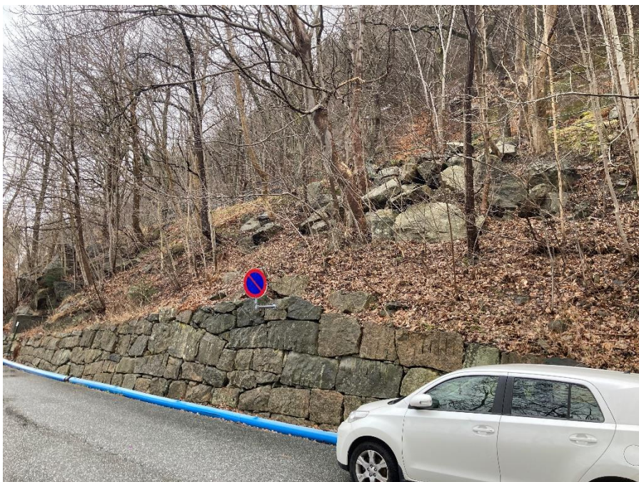
Foto 13: Avsetninger fra steinsprang mellom Fjellveien og Amalie Skrams vei. Foto mot nord.
