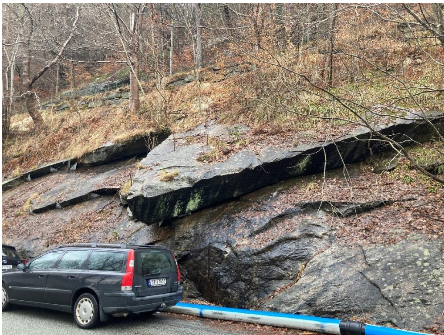
Foto 12: Avløste bergflak mellom Amalie Skrams vei og Fjellveien. Blokk er delvis sikret med gjennomgående fjellbolter og sperrebolter. Fall på sprekkesett er noe slakere enn skråningshelning. Foto mot nord.
