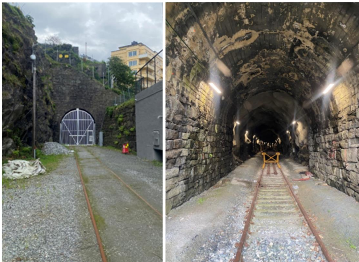
Figur 7.13: Portal med port sett fra Jernbanetomten (venstre) og første del av portal sett fra tunnelåpning (høyre). Sporene i dagen på Jernbanetomten er ikke i bruk i dag.
